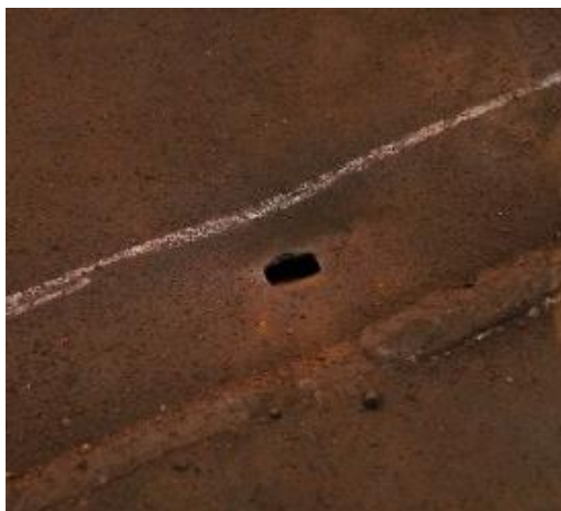
Figure 15 : arrachement coté extérieur
