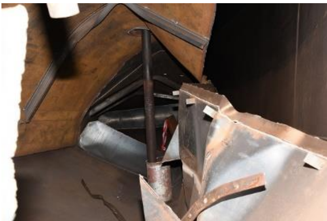
Figure 11 : dégâts internes des caissons - on note la cloison de séparation arrachée en partie supérieure
