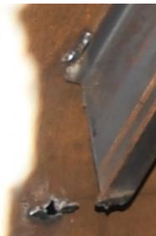
Figure 14 : arrachement coté intérieur du caisson
