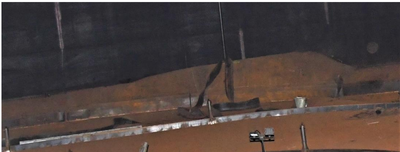
Figure 10 : vue d'ensemble des deux caissons (n°1 et 21) déformés
