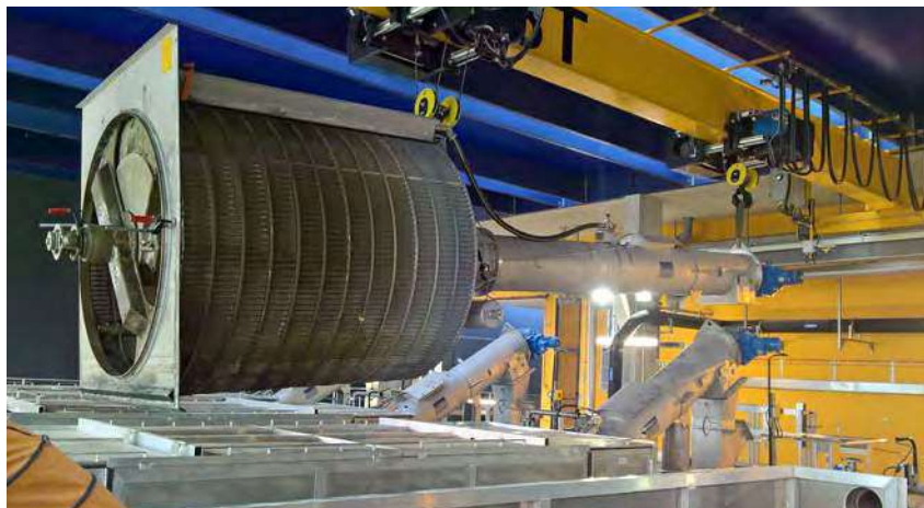
Un tamis RPPS STAR d'un diamètre de 2000 mm d'Huber Technology est en cours de levage pour sa maintenance réalisée par le SAV du fabricant.
